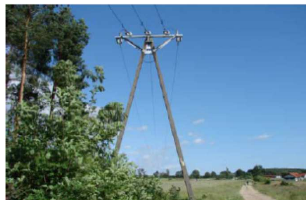
Linia 15 kV z przewodami izolowanymi
