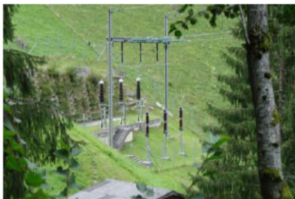
Linia kablowa 220 kV
