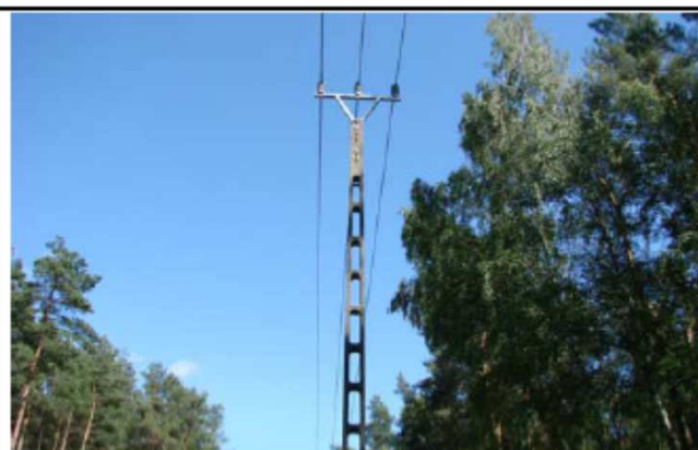
Linia 15 kV z przewodami izolowanymi
